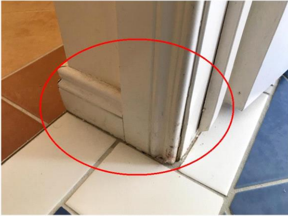
swollen door & trim timbers visible
